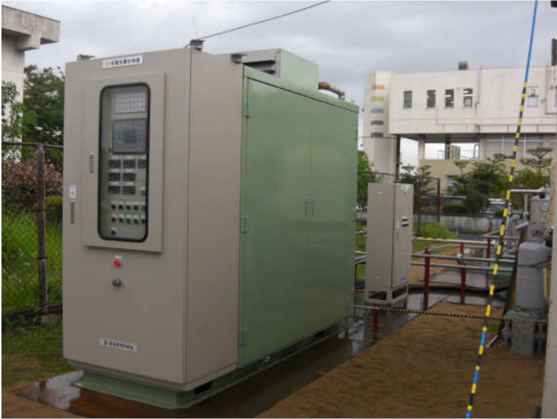
写真.1 ロータリーエンジン消化ガス発電ユニット外観
