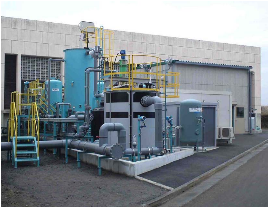
図3 実証試験プラントの全景
