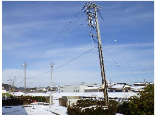
【電源喪失】引込柱傾斜 (珠洲市熊谷P)
