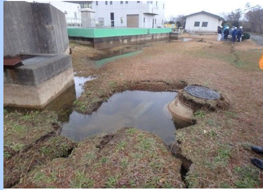
【地盤沈下】埋設配管の破損 (羽咋市羽咋T)
