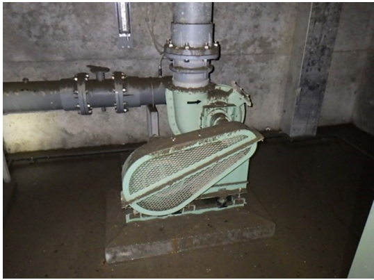
【地下浸水】機器部水没 (珠洲市野々江P)
