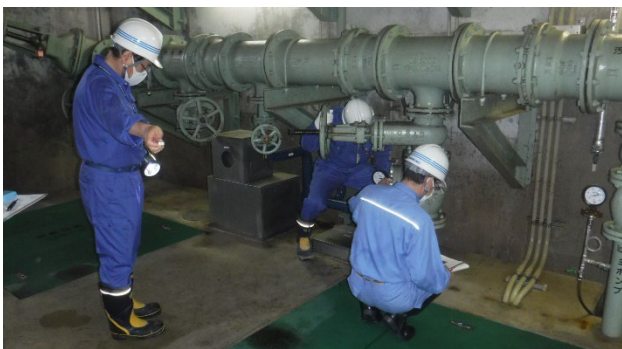
村上市荒川浄化センター 浸水状況の調査 (8/4)
