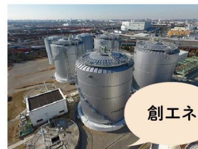
鋼板製消化タンク技術
