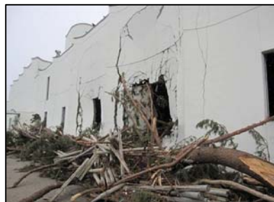
津波による施設の被害状況
