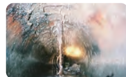
老朽化した管路施設の内部
