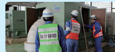
災害発生後一次調査状況
