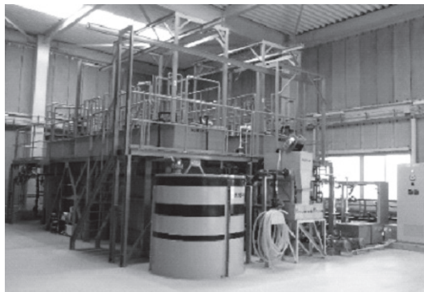
図4 活性汚泥処理実験プラント
