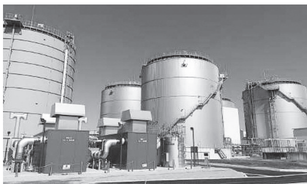
写真4 鋼板製汚泥消化タンク
