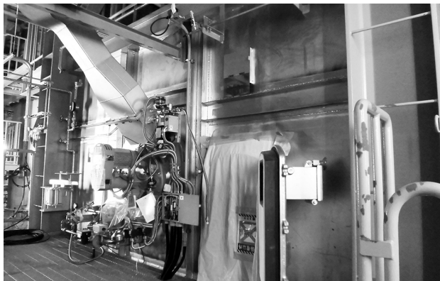
写真1 階段式ストーカ炉
