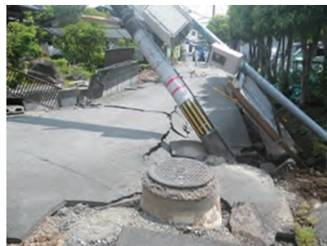
熊本地震による被害状況
