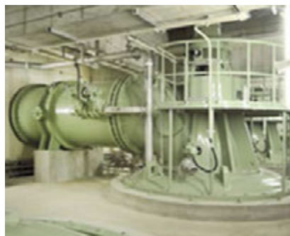
(NO.4 雨水ポンプ)
