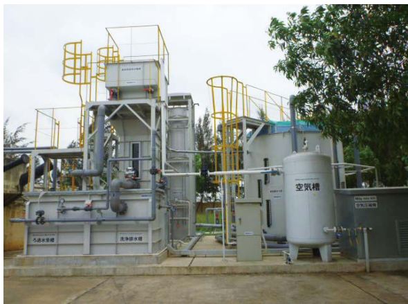
写真2 海外向け技術確認を実施した実証プラント
