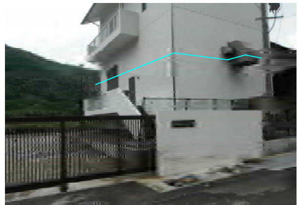
図10 被災状況写真
