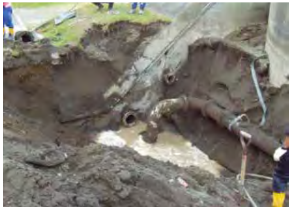
写真6 鷗川終末処理場 送水管等の破損状況
