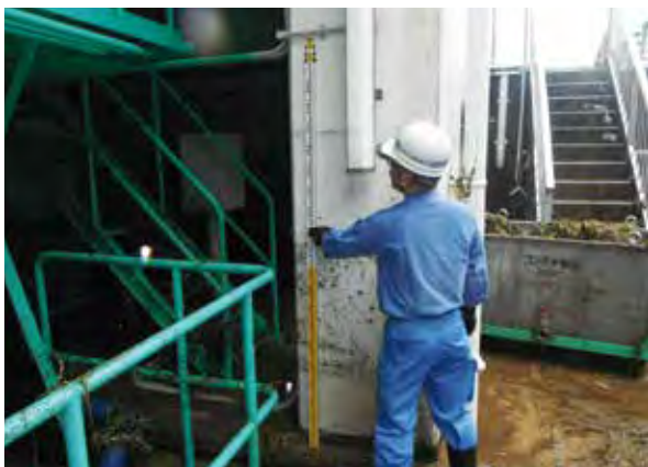
写真3 高梁市高梁雨水ポンプ場 除塵機被害状況調査
