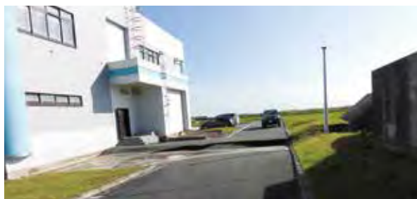
写真2 北海道胆振東部地震（平成30年9月） むかわ町鶴川終末処理場内の状況（地盤沈下）
