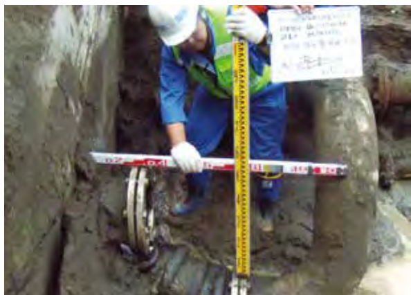
写真7 鷗川終末処理場 送水管破損調査
