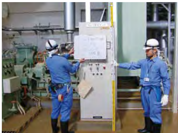
図6 被災状況写真
