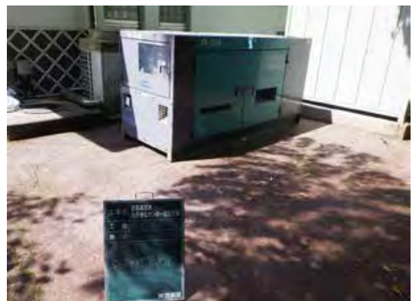
図4 仮復旧用仮設発電機
