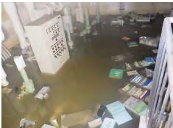
図3 地下ブロワ室の被災状況写真
