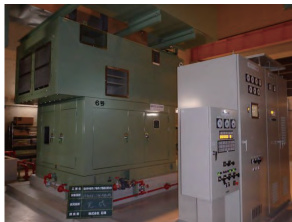
写真3. 6号雨水ポンプ用ガスタービン
