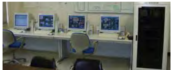
【遠方監視装置】
