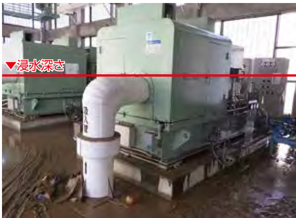
写真2 送風機（床面が泥水に覆われている）
