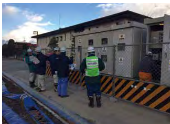
写真4 仮設受変電盤の設置状況
