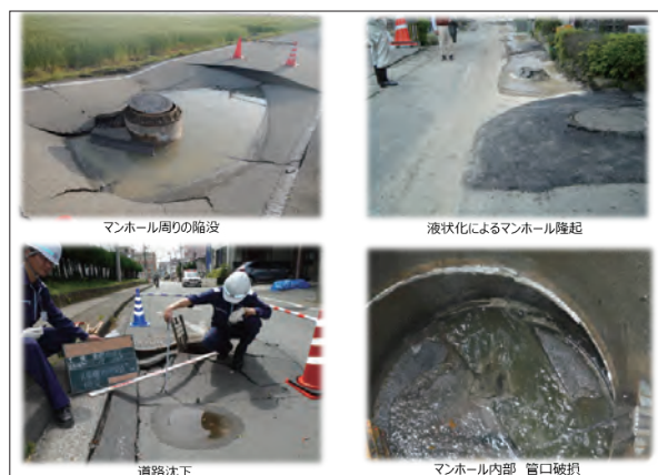
写真：人孔等被災状況
