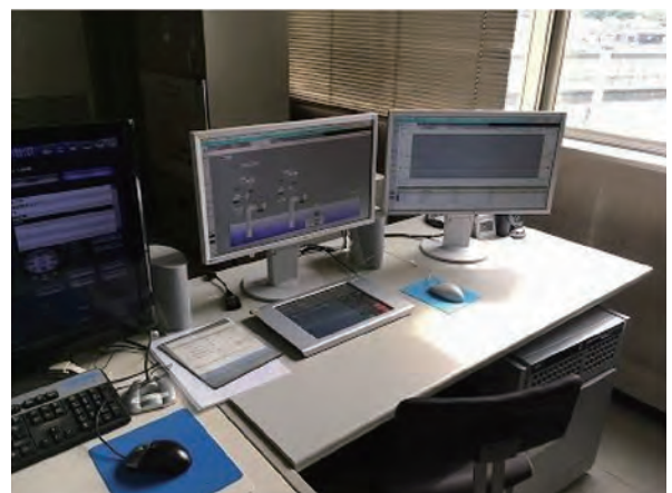
図 4 H 雨水ポンプ場遠方監視装置
