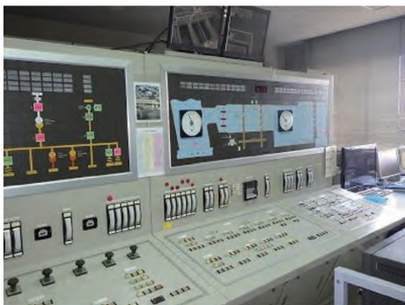
図 3 K 雨水ポンプ場グラフィック型監視操作盤
