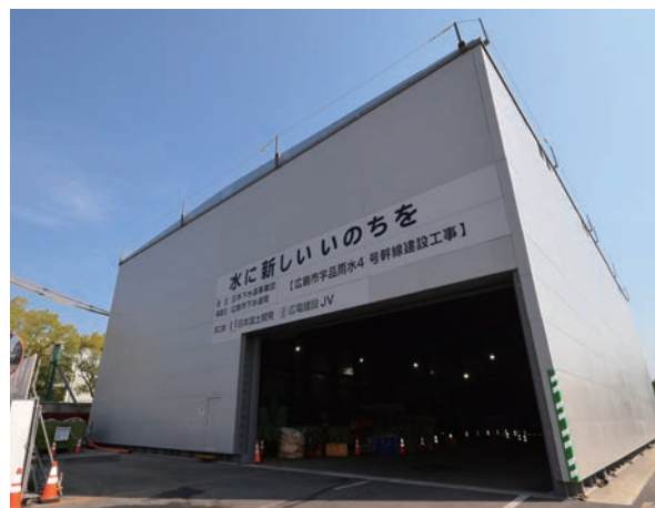
発進基地防音ハウス
