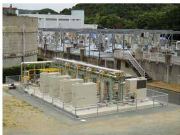
消化ガス発電設備（平成28年9月稼働） マイクロガスエンジン 25kw × 8台
