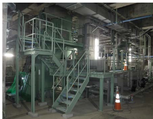
図8 新しい自動除塵機
