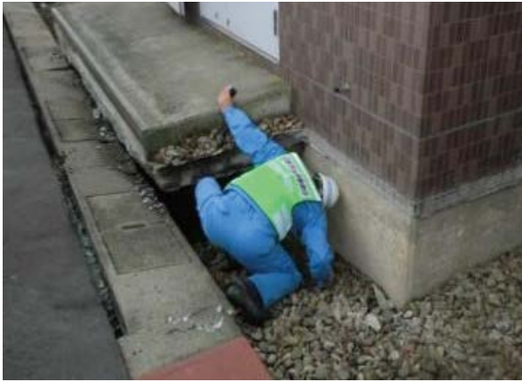
写真1：嘉島町上六嘉汚水中継ポンプ場の被害状況調査
