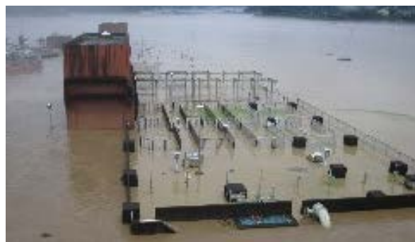
写真6：人吉市人吉浄水苑 浸水状況
