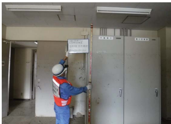
写真4：千曲川流域下水道下流処理区終末処理場の被災状況調査
