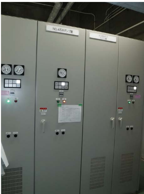
図9 新しいNo.4、5ポンプ盤
