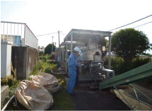
写真2：益城町浄化センター 仮設脱水機による汚泥処理状況
