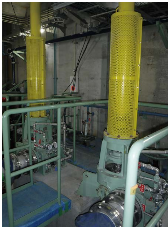
図10 新しいNo.4、5汚水ポンプ
