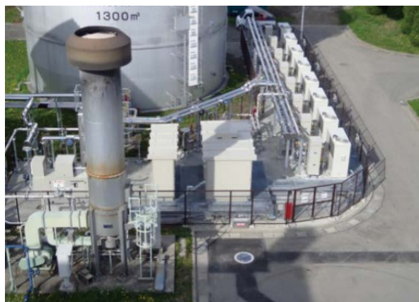
消化ガス発電（ガスエンジン方式）
