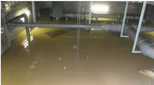
村上市羽ヶ榎中継ポンプ場 沈砂機械室の浸水状況（8/3）
