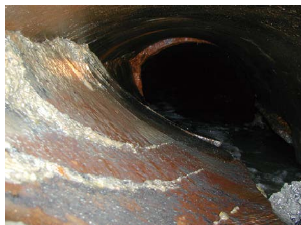
柳橋安政汚水幹線ヒューム管φ 1200mm 下部破損状況
