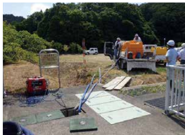
宮津湾浄化センターの処理水の給水の様子
