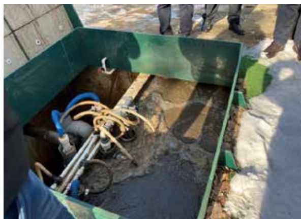
写真6 リゾート施設に導入されている組み立て式水処理施設
