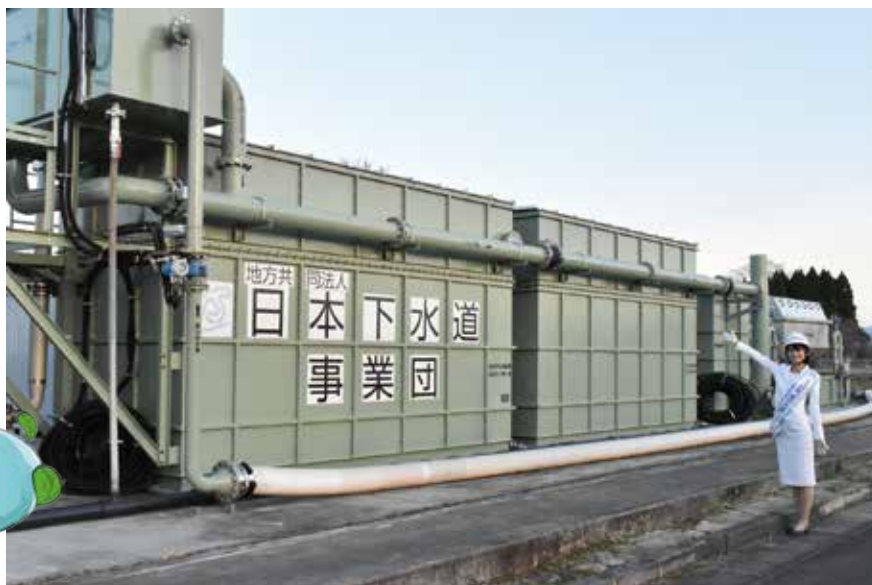
可搬式水処理施設（真岡市・JS 技術開発実験センター）
