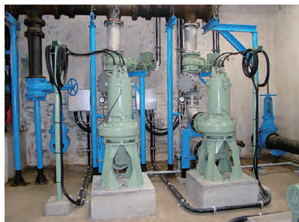
余剰返送汚泥ポンプ
