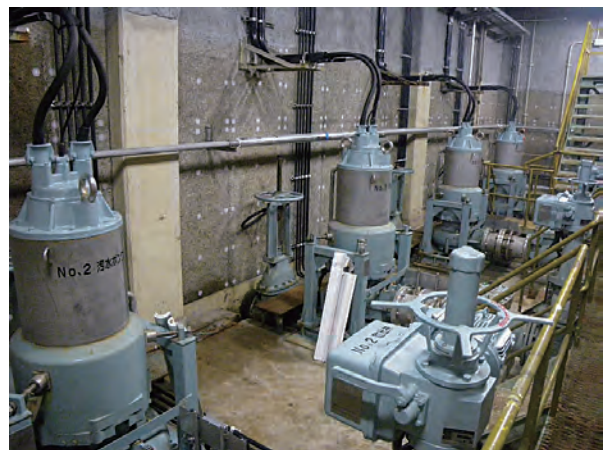
嬉石ポンプ場主ポンプ
