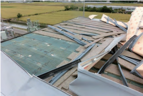
被災した岸本浄化センター汚泥管理棟の屋根
