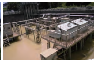
写真 6 ポンプ場被災状況 （段畑汚水中継ポンプ場）
