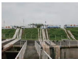
写真 7 排水ポンプ車 配備状況
