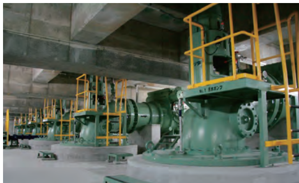
写真7 6台の汚水ポンプ
