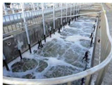
稼働する南蒲生浄化センター中級処理施設（30万m 3 /日）
