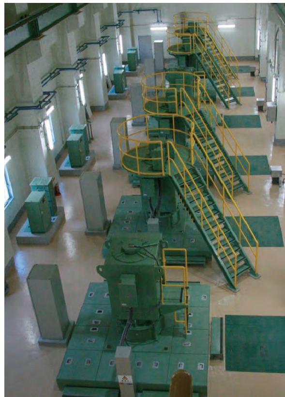
写真8 汚水ポンプ用高圧電動機
