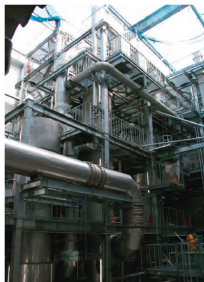
写真10 3号汚泥焼却設備
