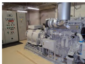
新管理棟3F 自家発電機設備
