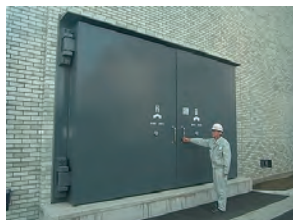
耐水扉設置 揚水ポンプ設備
