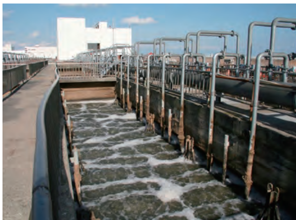
写真2 接触酸化法による暫定的な水処理施設
