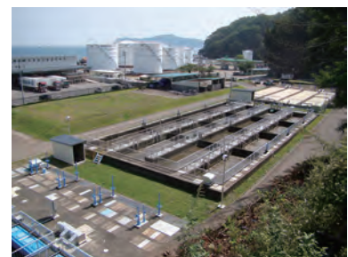
復旧した釜石市大平下水処理場（約12,800m 3 /日）
