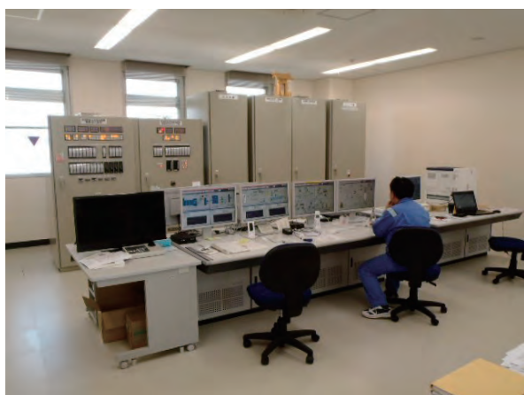
4F管理制御室
