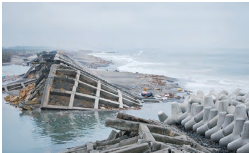
被災した宮城県の岩沼海岸(東北地方整備局提供)
