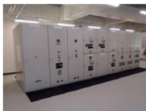
新管理棟3F 高圧受変電設備
