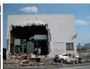
川口雨水ポンプ場 津波により壁が破損
