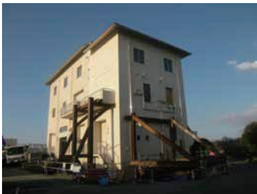
写真7 汚泥棟転倒防止対策状況
