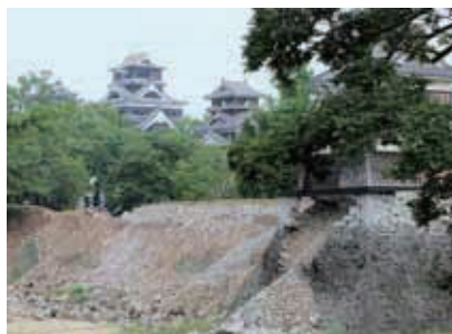
写真1 熊本城石垣の倒壊
