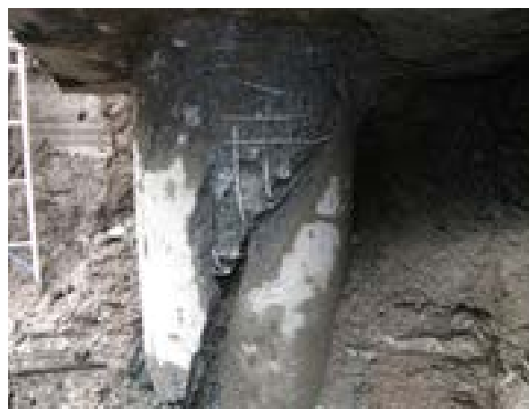
写真3 西北側杭破損状況
