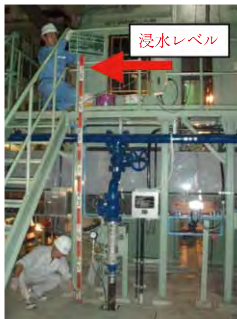
写真2 自動除塵機と浸水レベル
