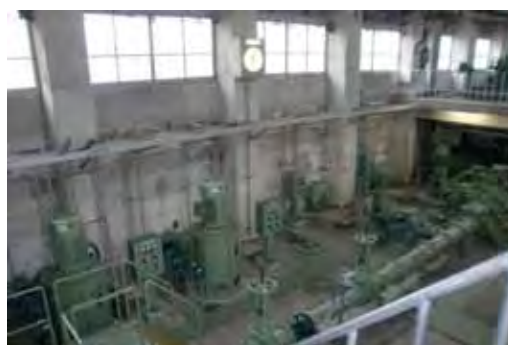
写真1 合流改善ポンプ、流域送りポンプ
