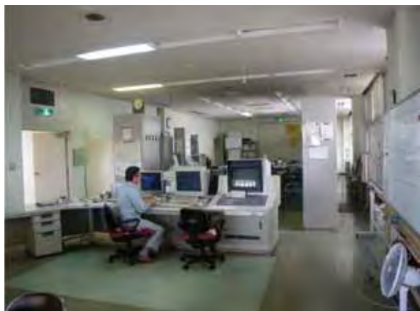
写真-2 中央監視室（旧）
