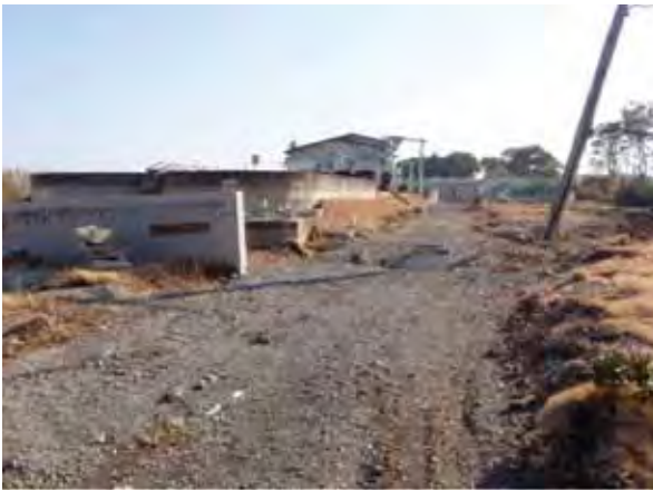
広野浄化センター（復旧前）
