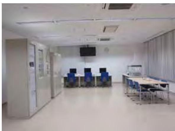
写真-3 中央監視室（新）
