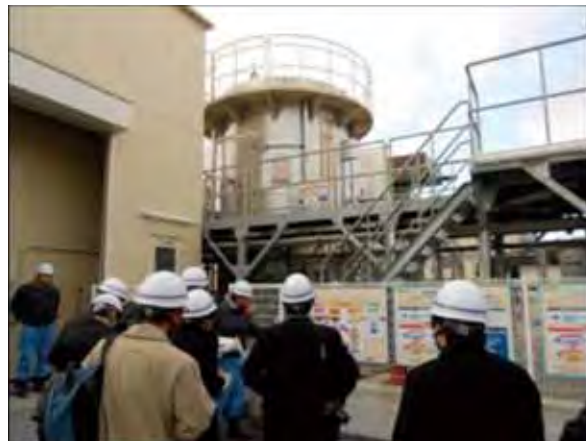
中浜下水処理場内 B-DASH 実証実験施設
