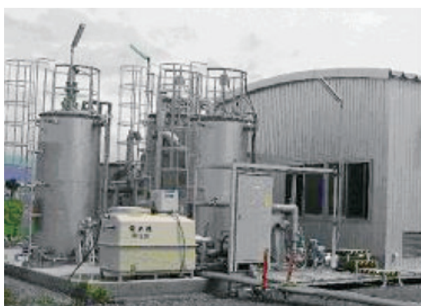
写真1 超高速嫌気性消化実証プラント（熊本県八代北部流域処理場）
