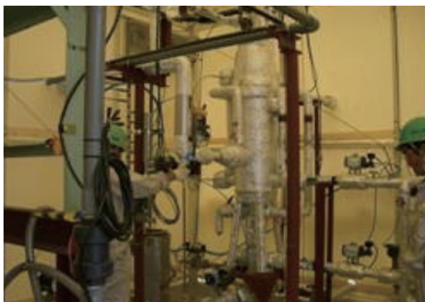
写真3 熱可溶化改質装置
