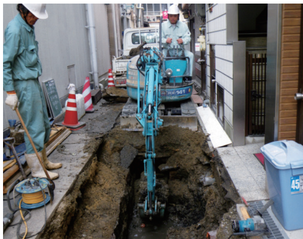
大型機械の作業が不可能（作業性が悪い）
