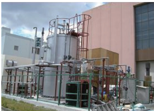
写真2 熱可溶化高効率嫌気消化の実証プラント (猪名側流域下水道原田処理場)
