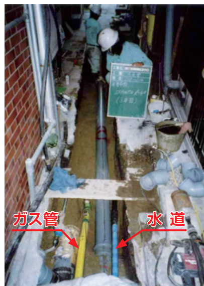
他のライフライン整備が完了済みのため、下水道管を埋設するためには、移設等の処置が必要
