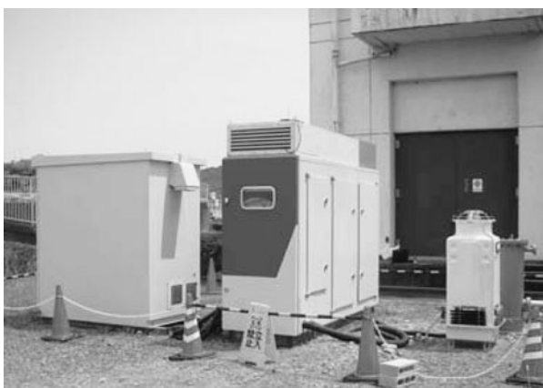
写真－4 ローターエンジンを採用した消化ガス発電実証試験機（飯能市浄化センター）
