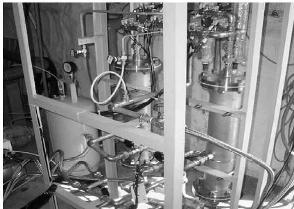
写真－3 VPSA消化ガス精製装置の 実証試験装置
