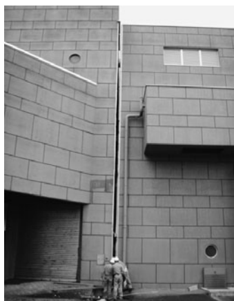
写真3 監視汚泥棟EXP.J金物の破損状況
