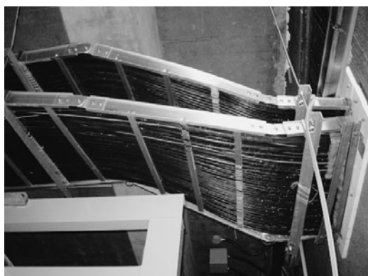
写真6 電気ケーブルの破損状況
