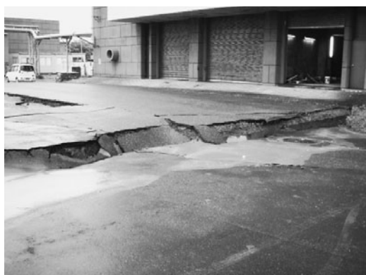
写真4 監視汚泥棟付近地盤沈下状況
