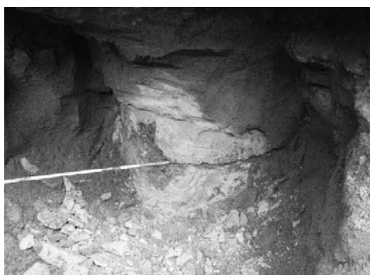
写真2 脱硫塔基礎杭の破損状況
