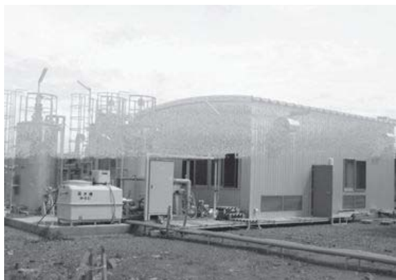
写真-1 実証実験プラント
