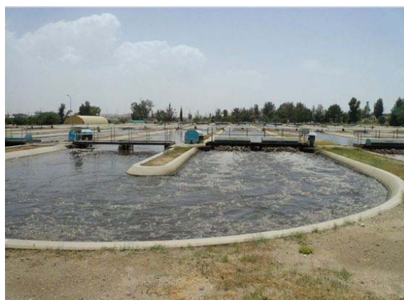
写真1 ハミースマシート処理場の水処理設備
