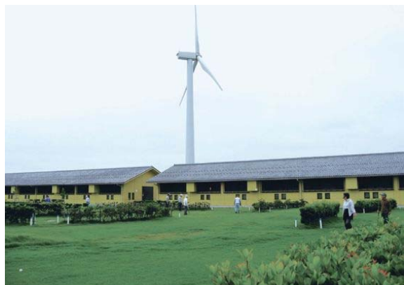
入善浄化センターの風力発電施設①
