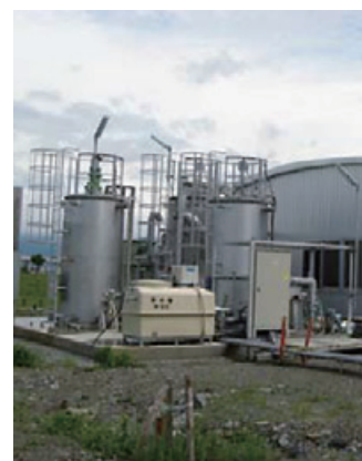
担体充填型高速メタン発酵技術実験プラント
