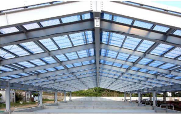
鹿児島県 知名町知名環境センター 天日乾燥床棟
