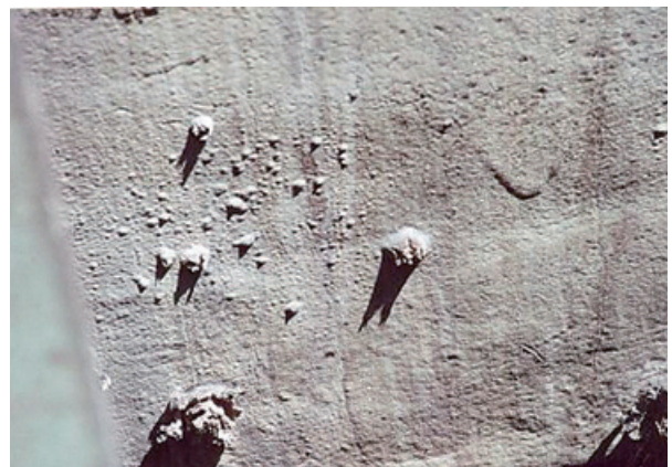
写真-1 防食被覆の穴が原因の不具合
