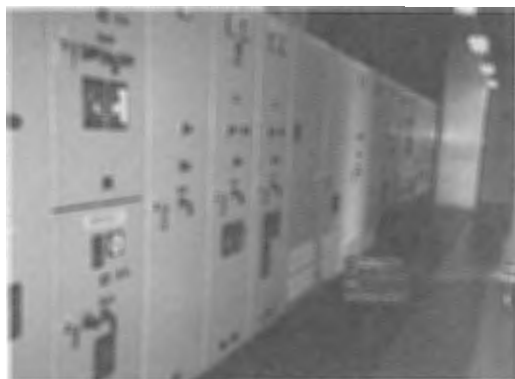
町田市鶴見川クリーンセンター 電気設備工事その10
