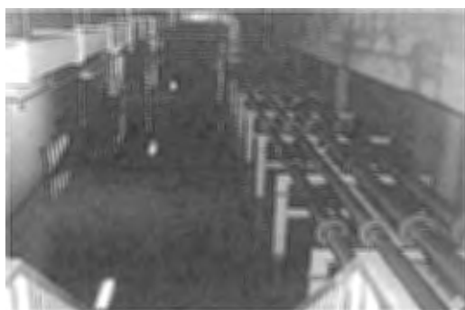
写真-5 水没した地下2階管廊
