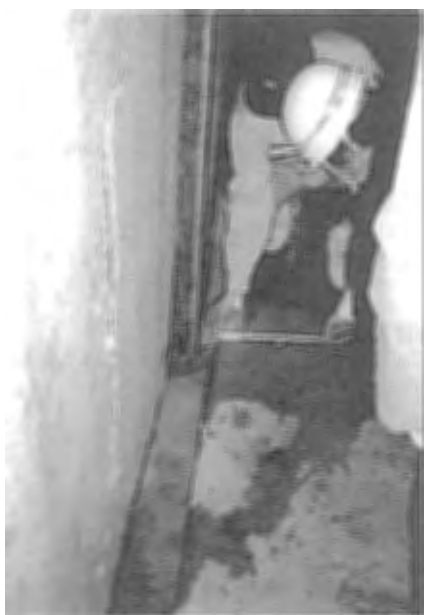
写真-4 エキスパンションジョイントのずれ
