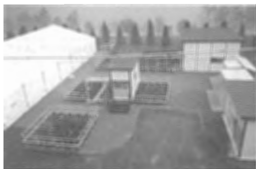
写真－７ 温泉地区仮設下水終末処理場全景 (左側テント内に回分槽)
