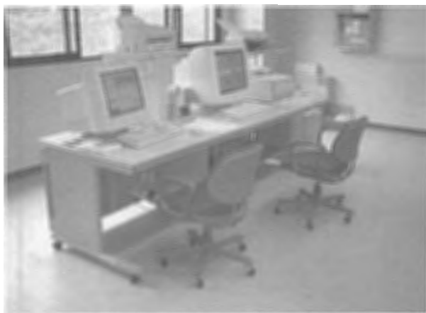
写真－2 遠方監視装置 4ヵ所の浄化センター、中継ポンプからのデータ、警報を受信
