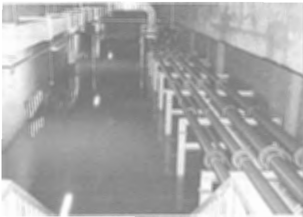
冠水した下水処理場地下2階管廊
