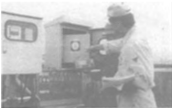
18. 滑川市浄化センター災害復旧関連電気設備工事
