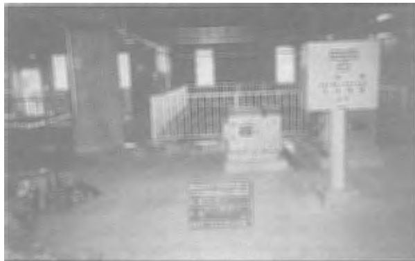
20. 阿智村会地浄化センター電気設備工事
