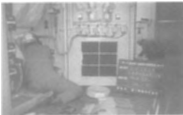
19. 諏訪湖流域下水道豊田終末処理場電気設備工事その38
