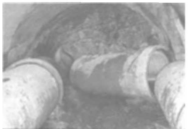
被災した下水道トンネル内部
