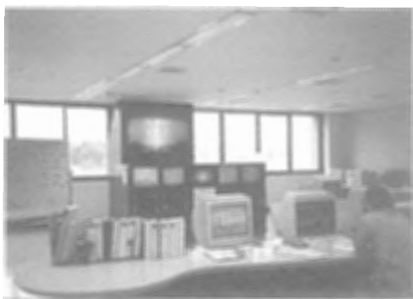
写真－3 中央監視室
