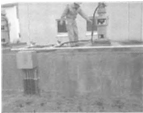
写真一 目視による運転状況の確認
