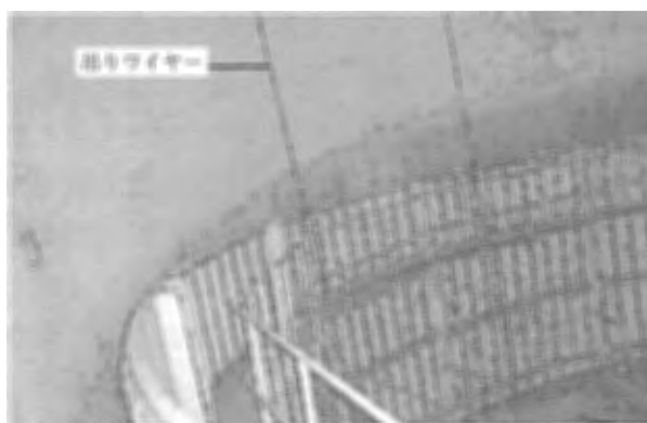
十日町市十日町下水処理センター消化ガスタンク設備内観写真
