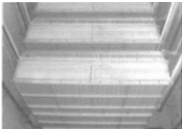
写真-2 福崎浄化センター膜ユニット
