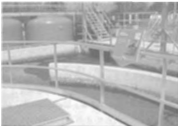
写真－３ ファッセフェルド処理場の生物反応タンク
