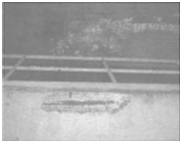
写真－2 劣化状況例
