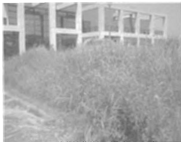
写真-3 雑草繁茂状況(反応タンク)
