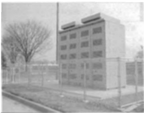
写真－１ NaS電池設備
