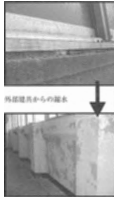
写真-2 外部建具からの漏水事例
