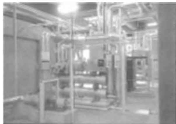
下水熱利用ヒートポンプ
