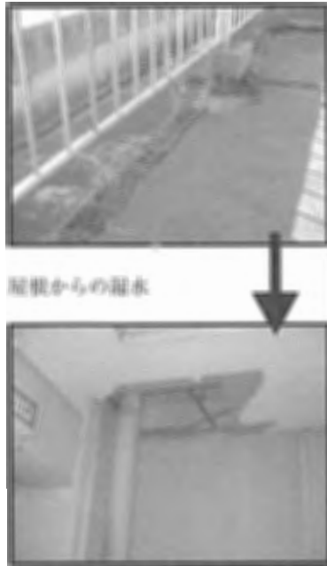
写真-1 屋根からの漏水事例
