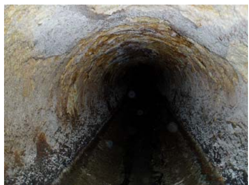
写真1 管渠内部の腐食状況
